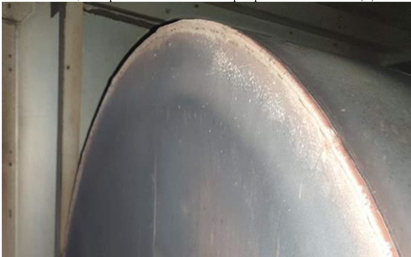
Стенка секции нагрева В300-ЕХ2 теплогенератора DaGaz Termo В300(V) №1
