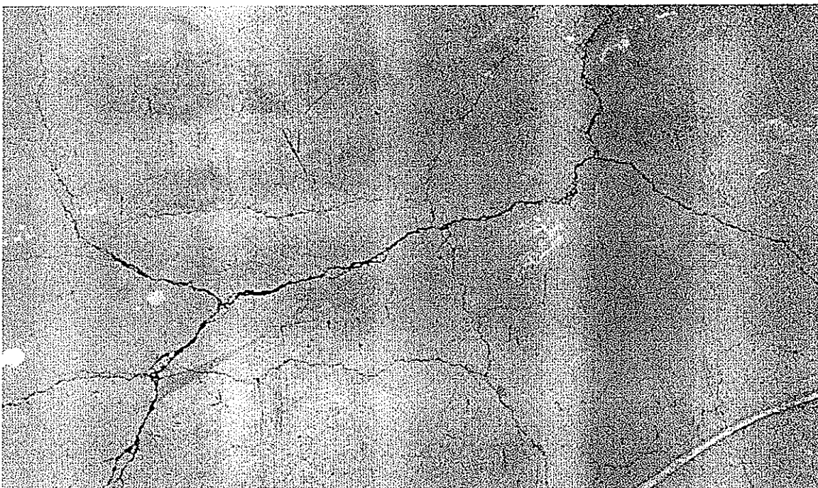
Фото 4-5. Трещины в упрочненных полах.
